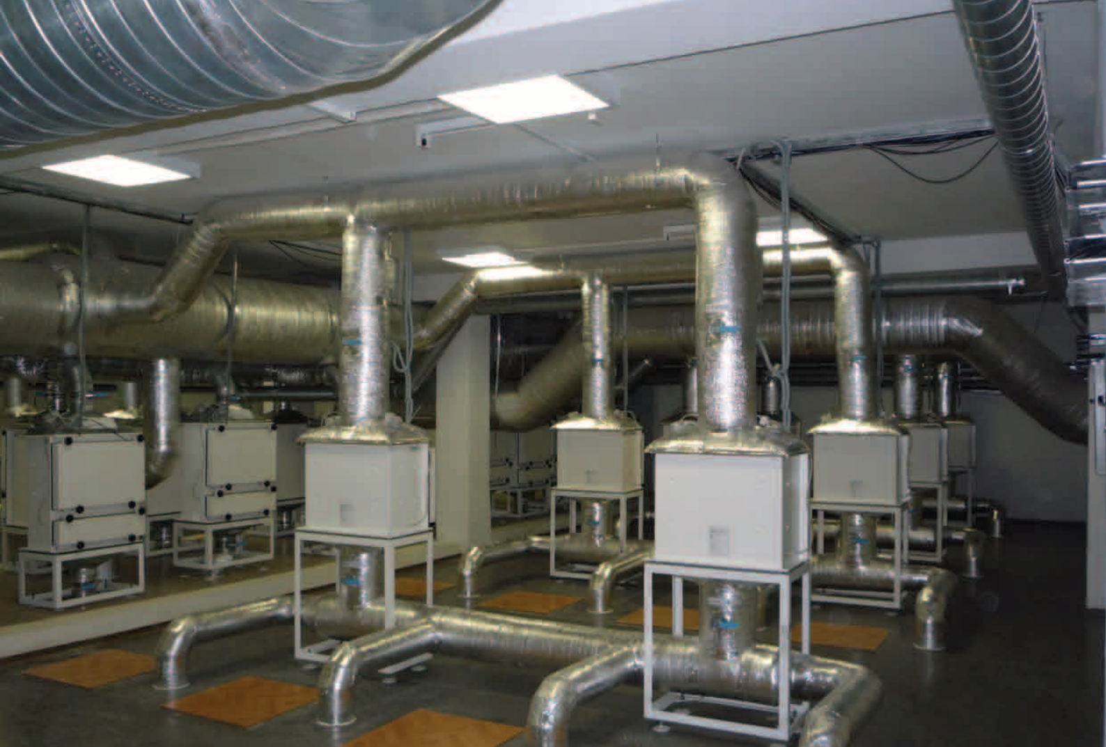
Виварий. Технический этаж, «грязный коридор» с передаточными окнами и фильтрами вытяжных систем
