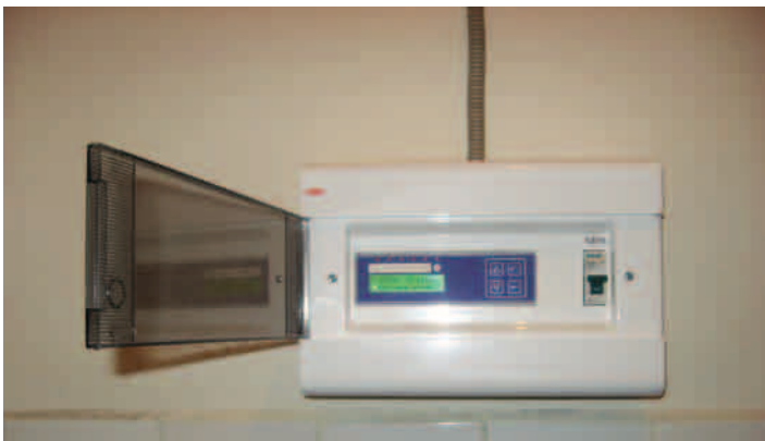
Система мониторинга медицинского газоснабжения
