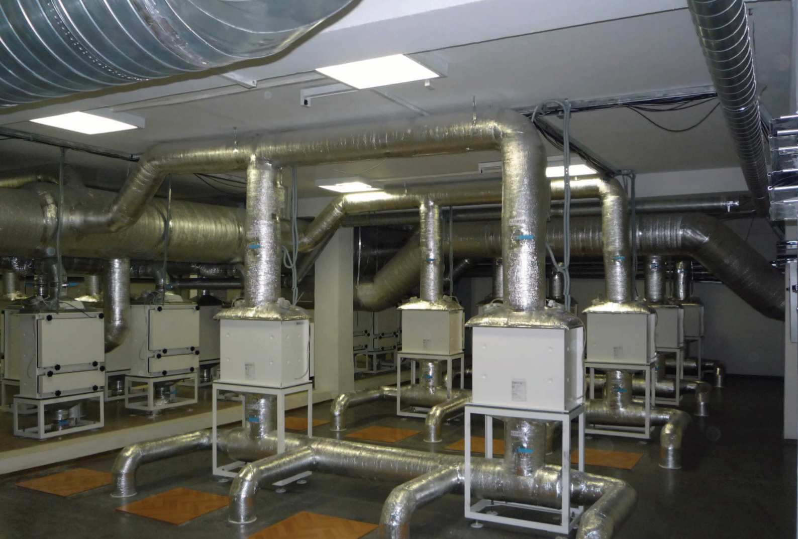
Виварий. Технический этаж, «грязный коридор» с передаточными окнами и фильтрами вытяжных систем
