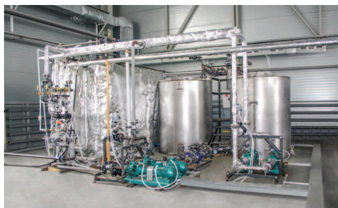
Установка обеззараживания стоков (УОС-АМС)
